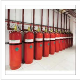
Mild Steel Novec 1230 Fire Suppression
